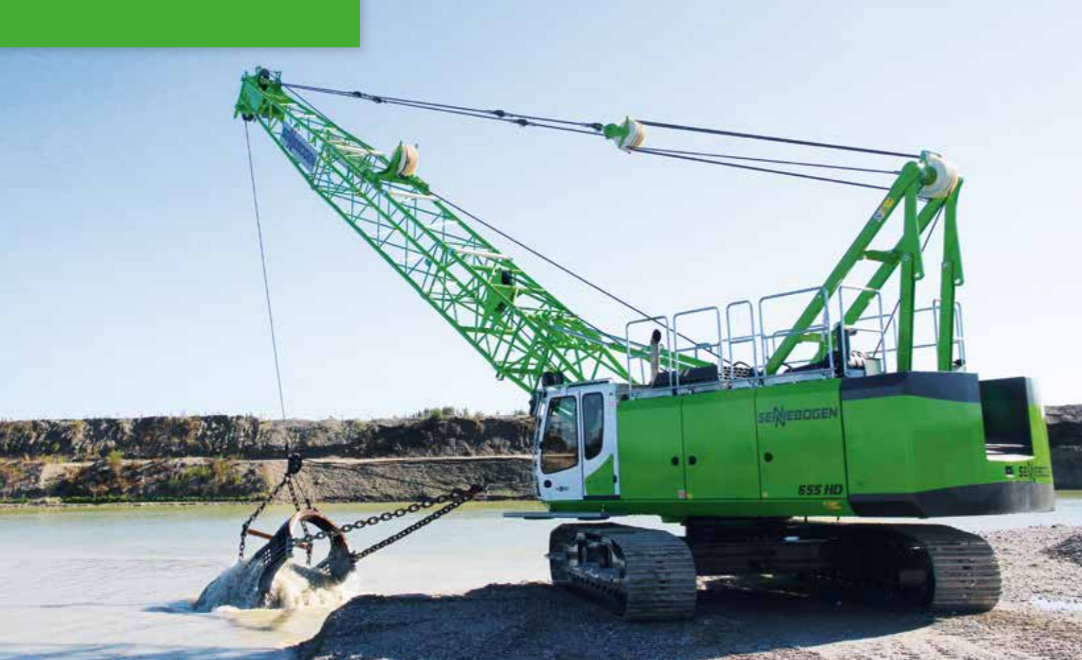
655 HD – Dragline operation with 3,5 cubic yards bucket; Germany 655 HD – Schleppschaufeleinsatz mit 2,7 m³ Schaufel; Deutschland
