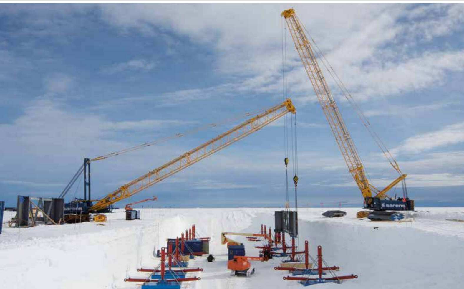
3300 – Construction works at polar research station Neumayer; Antarctica 3300 – Aufbau der Polarforschungsstation Neumayer; Antarktis
