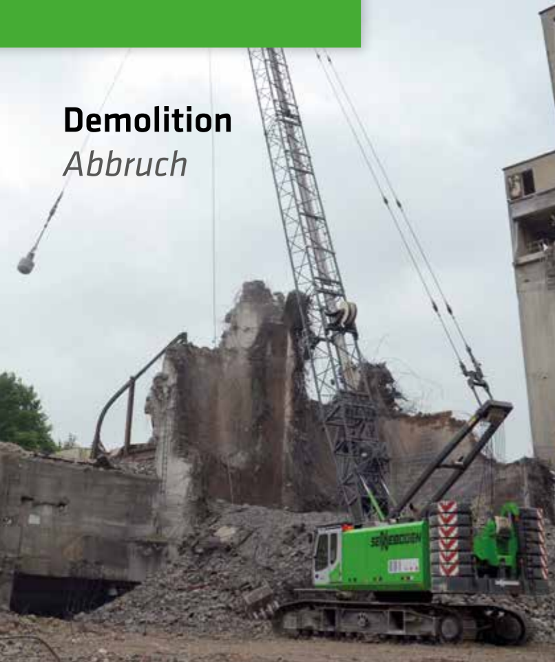
690 HD – Demolition works with wrecking ball; Germany 690 HD – Einsatz mit Abrissbirne; Deutschland
