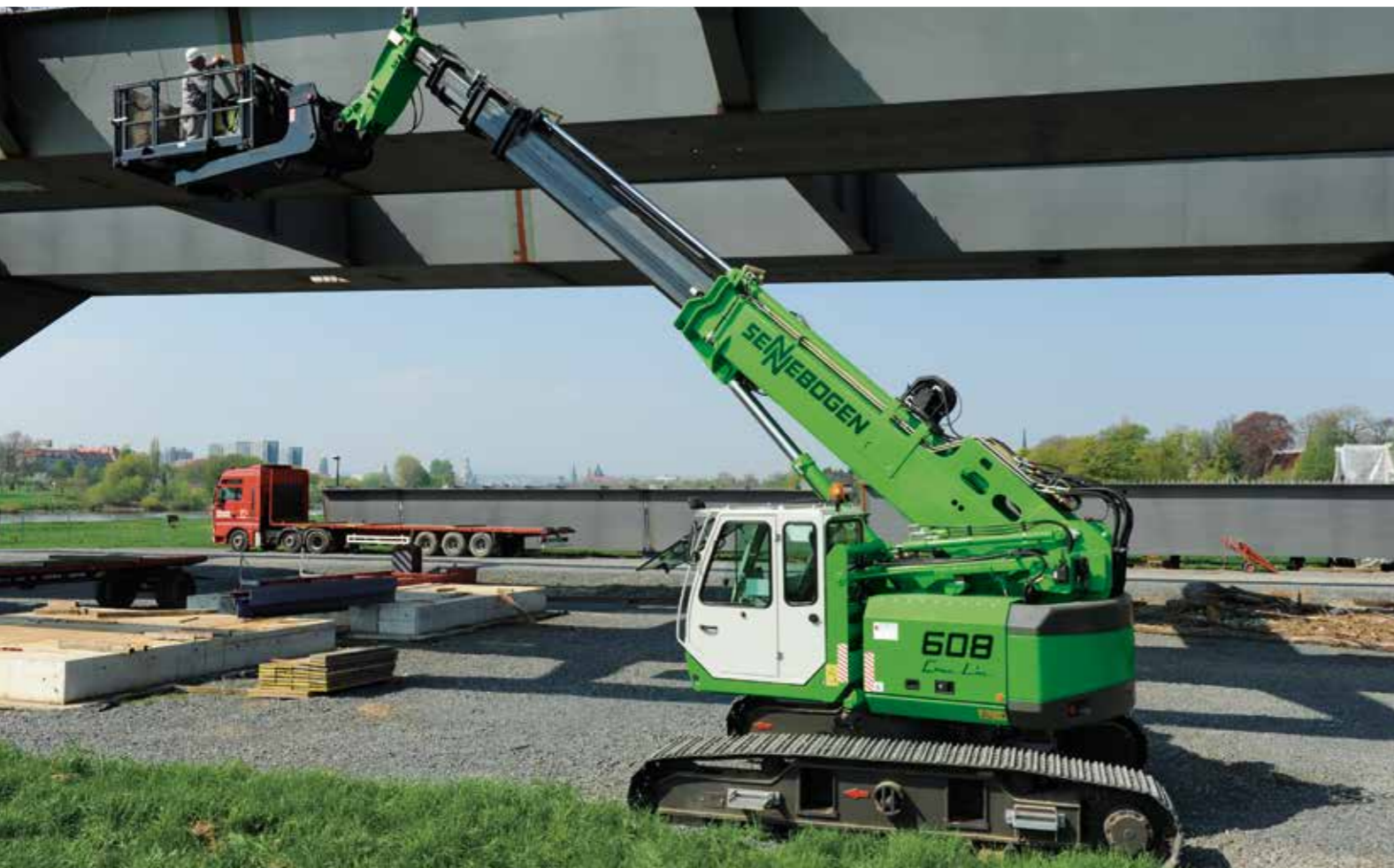
608 R – Inspection of bridges with 360° working platform; Germany 608 R – Inspektion von Brücken mit 360° Arbeitsplattform; Deutschland
