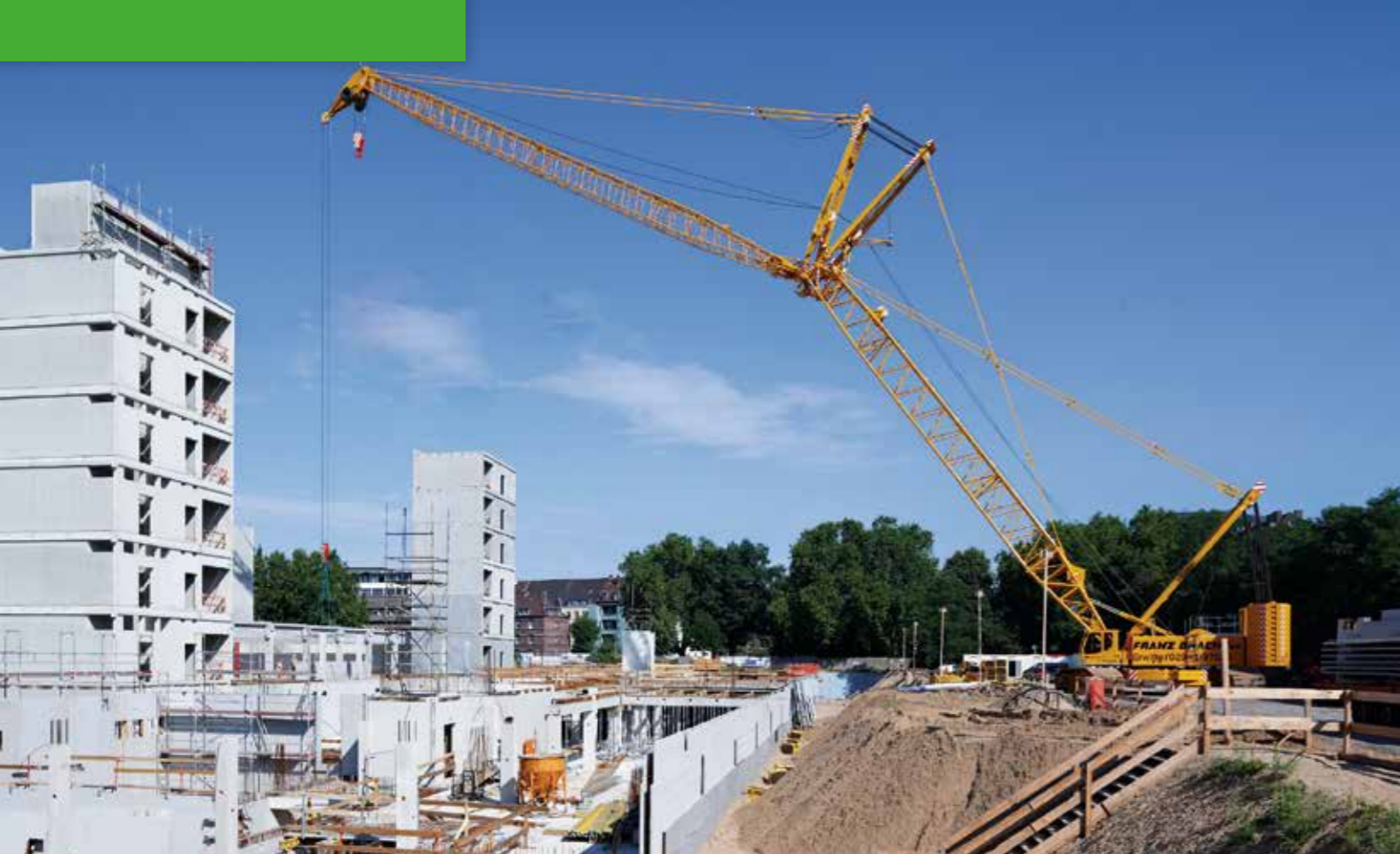
7700 - Hoisting works of concrete-prefabricated parts with auxiliary jib; Germany 7700 - Hebearbeiten von Beton-Fertigteilen mit Schnabelausleger; Deutschland
