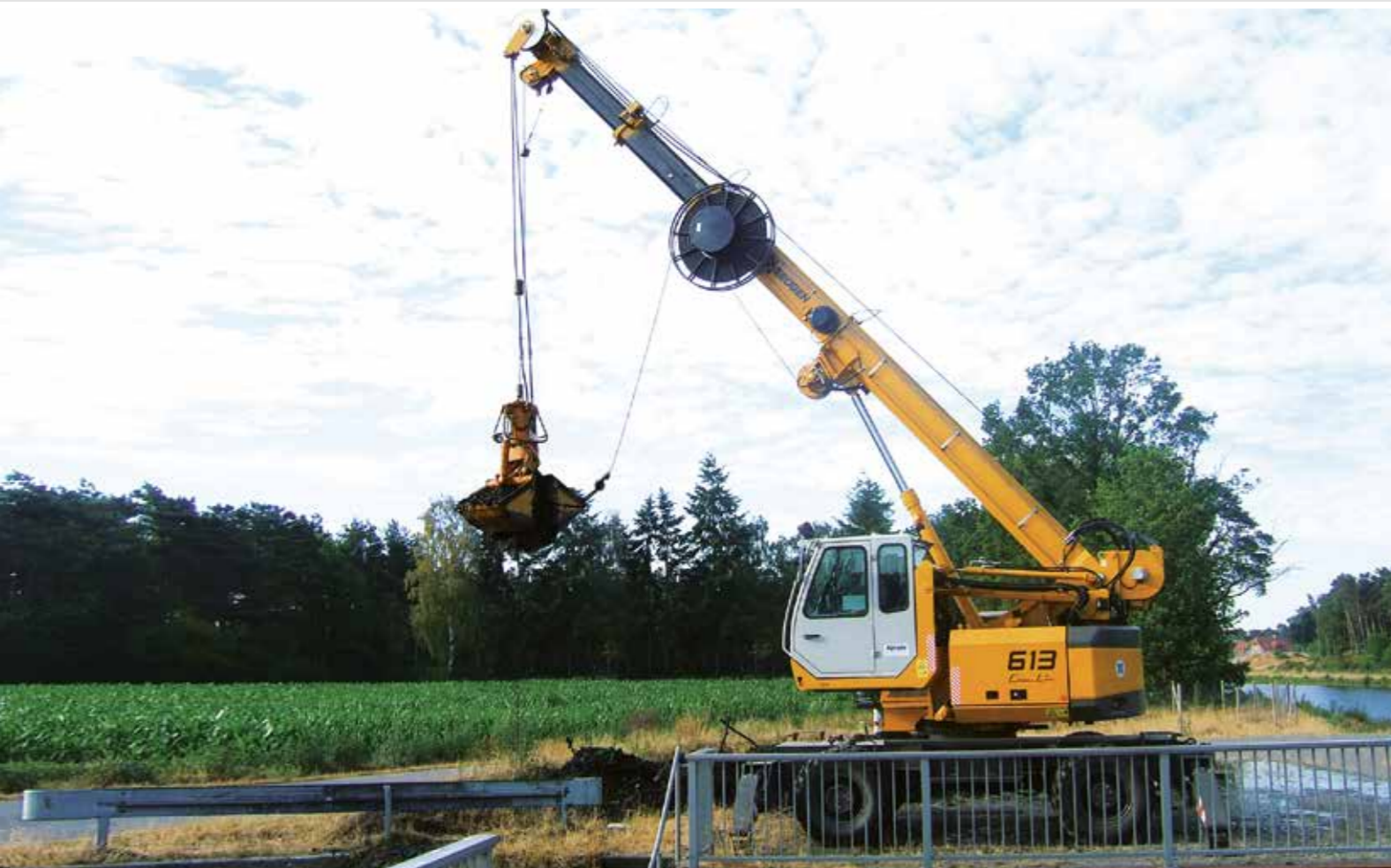
613 M – Clamshell operation in hydraulic construction; Germany 613 M – Zweischalengreiferbetrieb im Wasserbau; Deutschland
